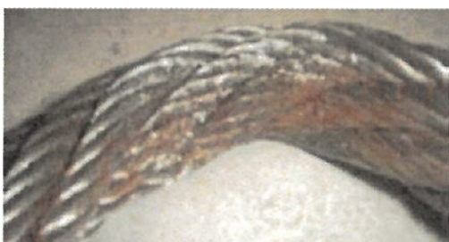
corrosione da ossidazione
